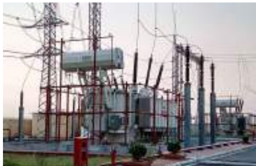
Trạm biến áp ngoài trời
