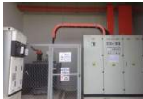
trạm biến áp trong nhà
