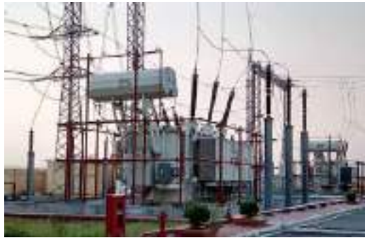
Trạm biến áp ngoài trời
