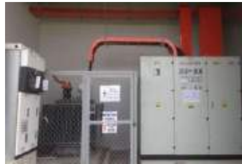
trạm biến áp trong nhà
